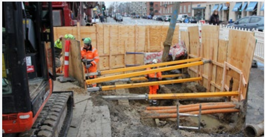
GIS- og dokumentationsarbejderne tager ud for at måle op, når der bliver etableret nye ledninger i Frederiksbergs undergrund. Så kan de indhente informationer, der betyder, at forsyningen kan dokumentere præcis hvor og hvor dybt, de nye ledninger ligger.
