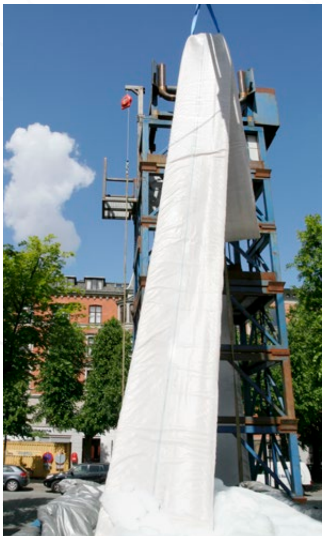
I december 2019 blev en 370 m lang hovedkloakledning renoveret. Det sker ved at presse en enorm "polyesterstrømpe" ned i kloakken og derefter hærdne den med varmt vand.
